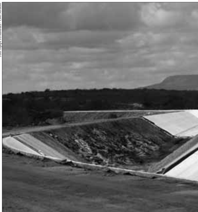
Destruição causada por obra do PAC, na região nordeste
